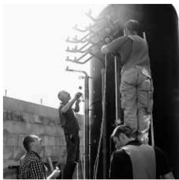
11,8 Kubikmeter Wasser fasst der Wärmespeicher, der von Solarkollektoren und dem Kamin gespeist wird.
